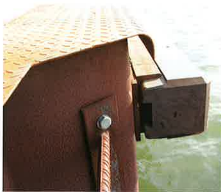
De traanplaat op deze kade aan het AR-kanaal in Utrecht werkt als schuurpapier.
